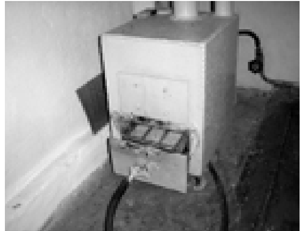
Рис.36. Водонагревательный котел для отопления дома с излучающими керамическими нагревателями в с. Петровка
