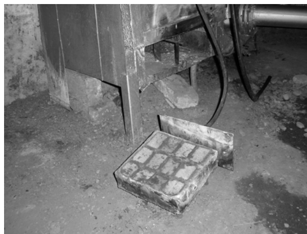
Рис. 28. Водонагревательный котел системы обогрева реактора в с. Петровка Фото: Веденев А.Г., ОФ «Флюид»
